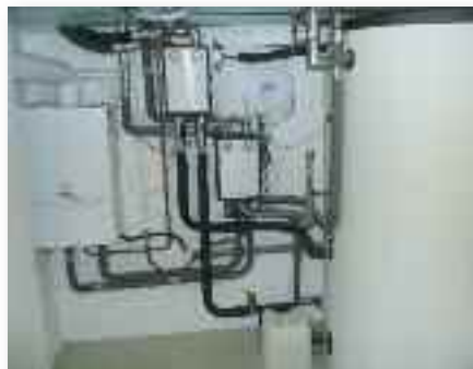
Moderne Brennerheizung mit großem Speicher für das solar erzeugte Warmwasser
